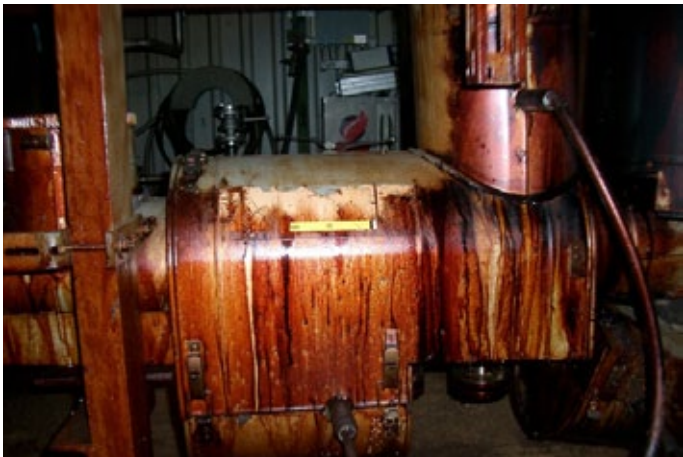
Verdreckter Dampfkessel – vorher.
